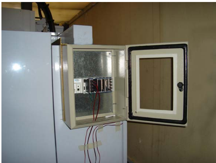
Σχήμα 2.29: Εγκατεστημένος πίνακας και μονάδα συλλογής και πρόσκτησης δεδομένων
