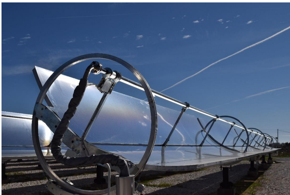
Εικόνα 4.3: Άποψη σειράς εγκατεστημένων παραβολικών συλλεκτών
