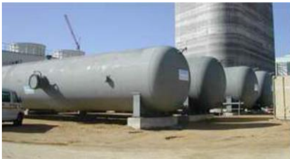
Εικόνα 3.4: Δεξαμενές αποθήκευσης πεπιεσμένου ατμού ηλιοθερμικού σταθμού [17]
